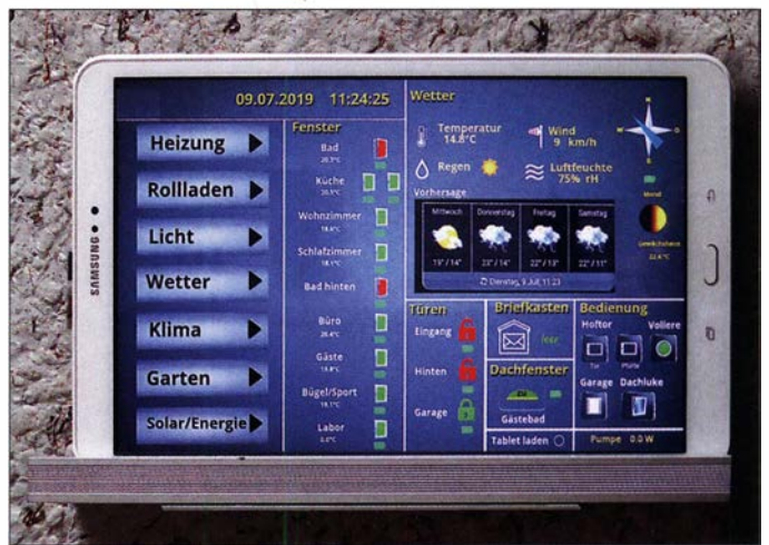
Bild 12: Ein 10,1"-Tablet ist als Frontend der Steuerung zentral im Flur platziert. Es gibt Auskunft über alle Systemzustände und erlaubt die einfache Bedienung.
